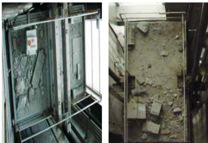
Figura 13 - Parti di contrappeso cadute sulla cabina Figure 13 - Counterweight slice/bricks fall on the car
